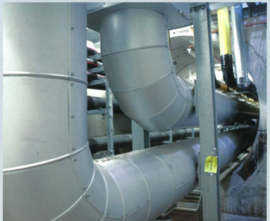
Blick in das Schachtbauwerk mit der Einmündung der mächtigen Fernwärmeleitungen aus der Vertikalen in den Infrastrukturkanal.
