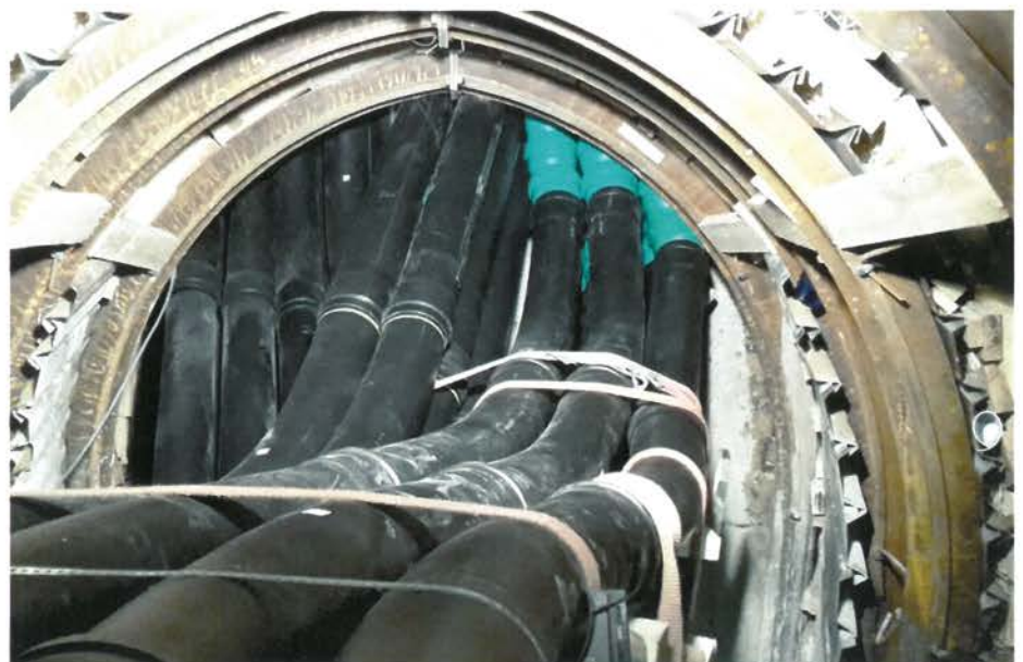
Leerrohrbelegung im Stollen
