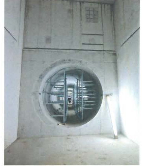
Blick aus einem Schachtbauwerk in den Infrastrukturkanal mit Montage- und Tragsystem.
