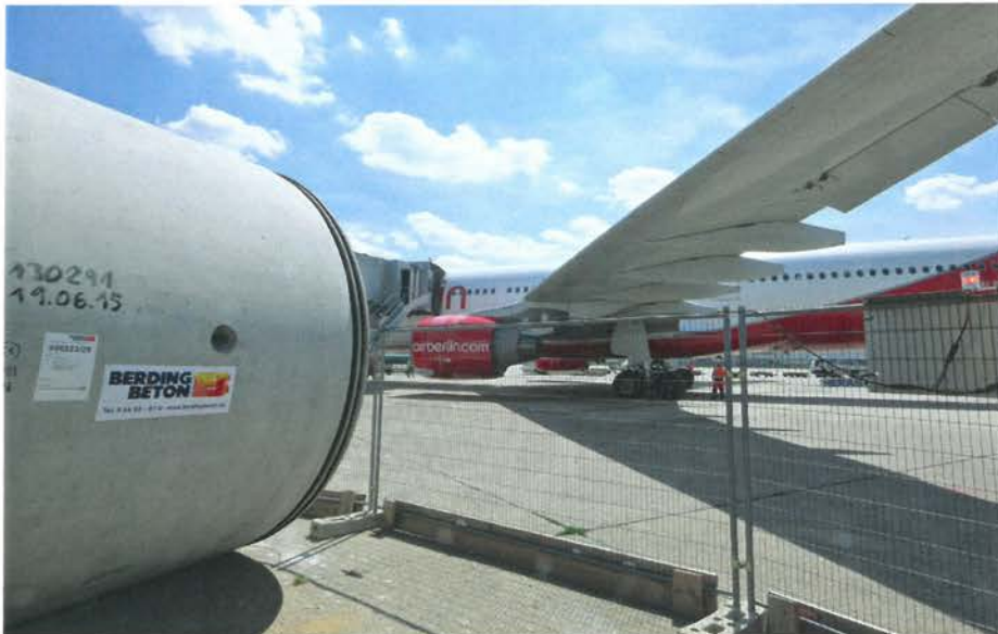
Hochleistungs-Stahlbetonrohre mit einem Außendurchmesser von 3400 mm wurden Rohr für Rohr in Sondertransporten und genau festgelegten Zeitkorridoren auf die Baustelleneinrichtungsfäche geliefert.
